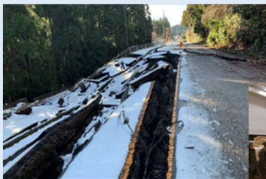
地割れ[能登半島地震]
