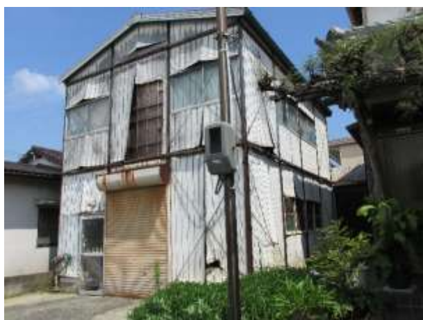
応急措置実施前
