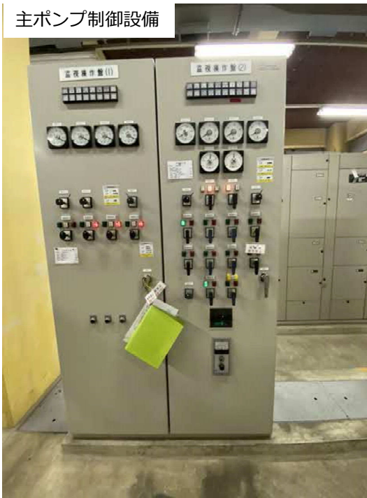
主ポンプ設備
